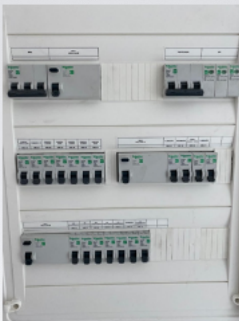
Figura 2 - Quadro elétrico do apartamento
