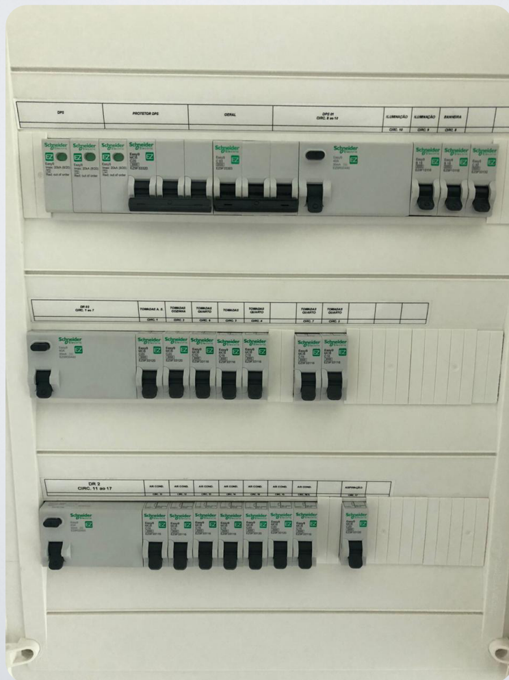
Figura 2 - Quadro elétrico do apartamento
